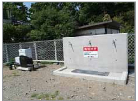
市内コミュニティセンターの防災井戸
