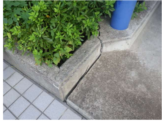
⑧ 通路床の隙間、花壇のひび割れ（外部北面）
