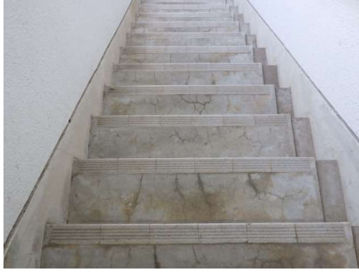
⑦ 床モルタルのひび割れ（外階段）
