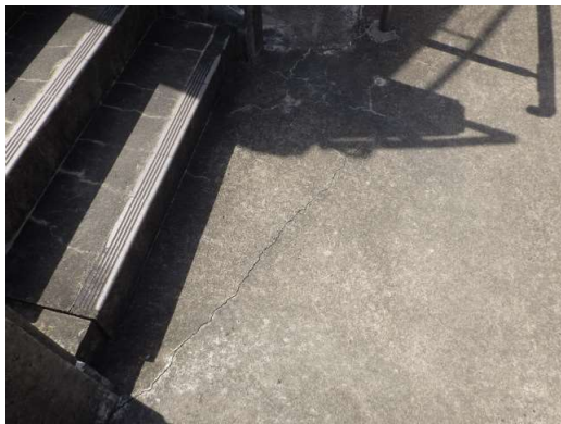
⑨ 舗装のひび割れ（スロープ）
