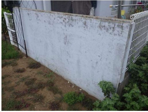
⑦ 塀のひび割れ（外部南面）
