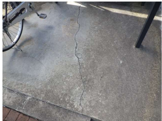
⑩ 舗装のひび割れ（駐輪場）
