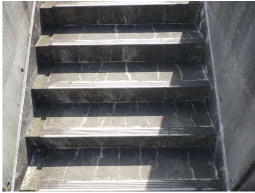
⑦ 床モルタルのひび割れ（外階段）
