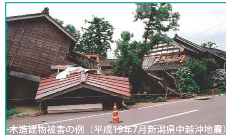
木造建物被害の例（平成19年7月新潟県中越沖地震）
