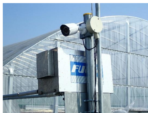
防犯カメラの設置
