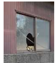
窓が割れた 管理不全空家
