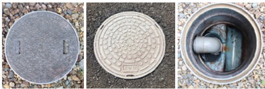
／自宅の汚水桝を確認してみよう／
