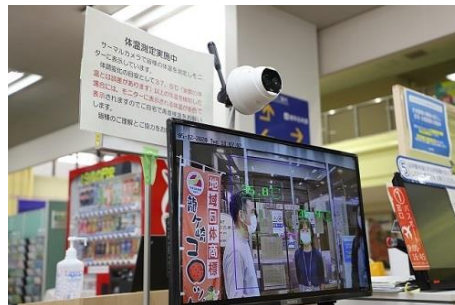
図表8 非接触型体表面温度測定機 の設置
