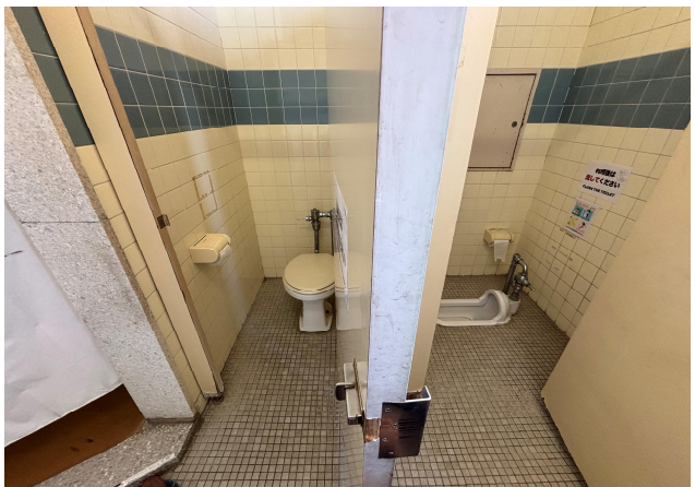
<トイレ> 洋式・和式トイレ
