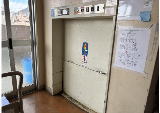
<配膳室> 昇降機
