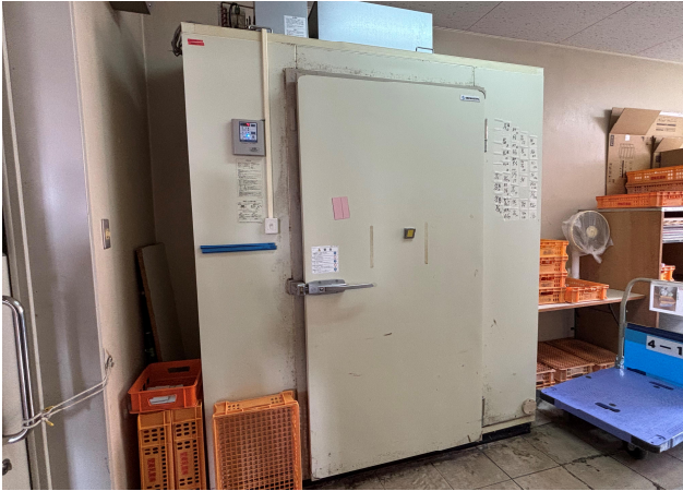
<配膳室> 冷蔵・冷凍庫
