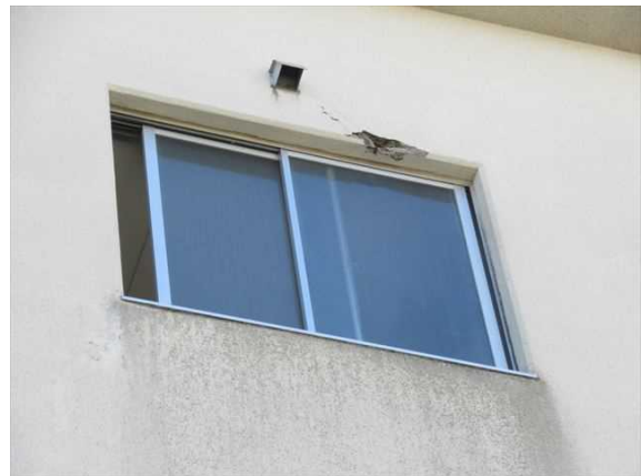
外壁の劣化（龍ヶ崎西小学校 校舎棟）
